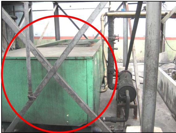
รูปที่ 3.19 แสดงเครื่องทำน้ำเย็น 50 ตันความเย็นก่อนการปรับปรุง
